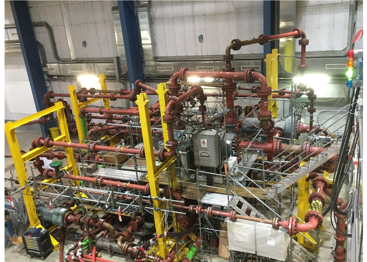
Aufbau der Testanlage mit einem 5 MW hermetisch gekapselten Motorkompressor
